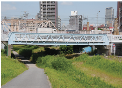
下流側からみた浜中津橋。十三小橋から転用された際にれんが製橋台からコンクリート橋台に変更し橋を改造して延長した様子がわかる
