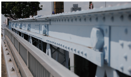
トラス上弦材の様子。斜材を留めるボルトとリベットが規則正しく並んでいる
